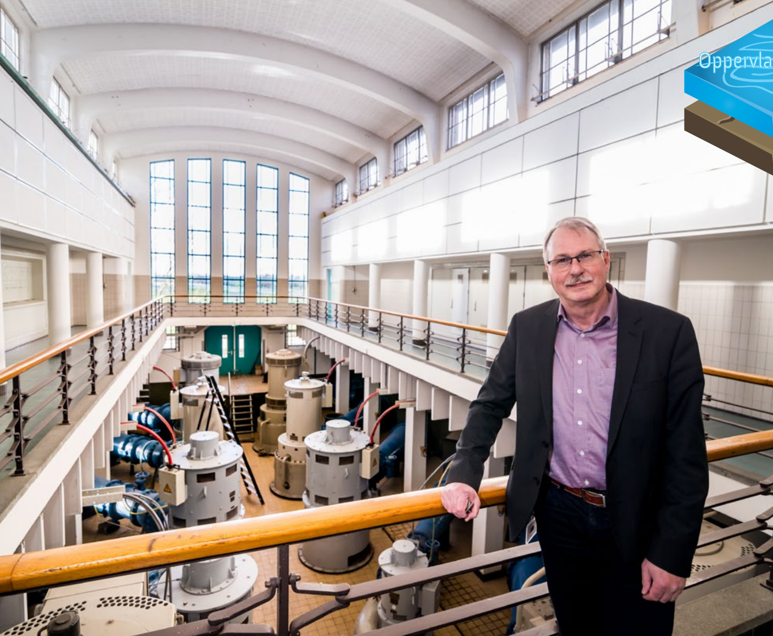
Procesmanager Jaap Mos in filtergebouw Bergambacht.
